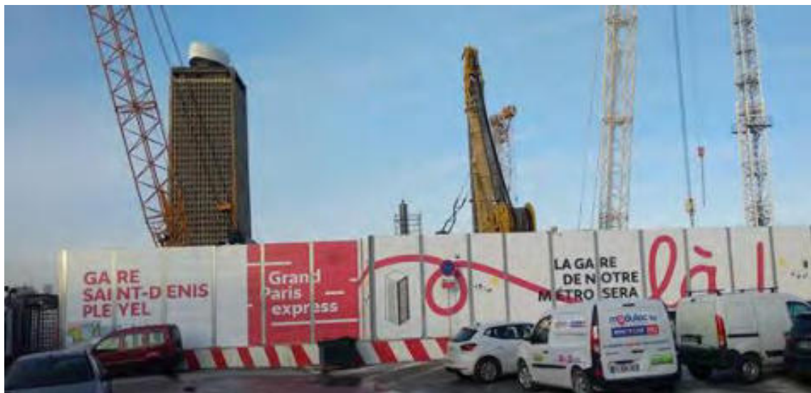
Figure 9. Photographie du chantier de la Gare Pleyel (avec la Tour Pleyel au fond) depuis la zone d'entrepôts du futur secteur du « Méta-îlot ».
